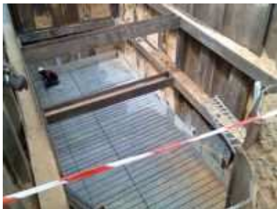
Système de blindage de la cuve à fioul.
